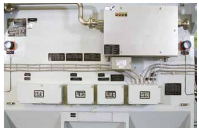
Dispositivo de presurización
