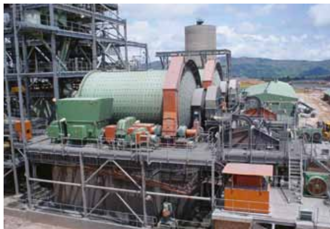
Suministro: 6.500 kW, 11.000 V, 6 polos, carcasa 900 Aplicación: Molino de bolas
