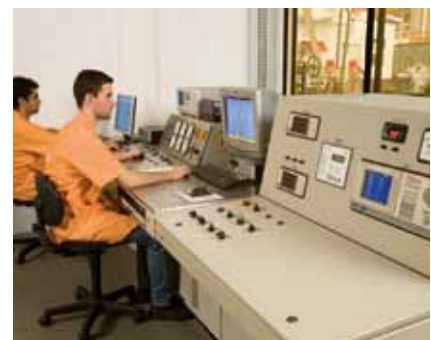
Sala de control
